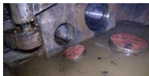
X-2ペネ外扉の状況（C方向から撮影）
