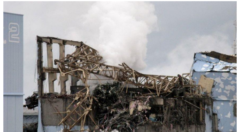
事故時の3号機原子炉建屋の様子
